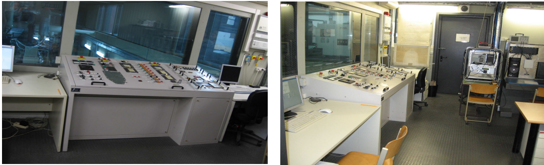
Σχήμα 4. Το δωμάτιο ελέγχου (control room) της κλίνης δοκιμών
